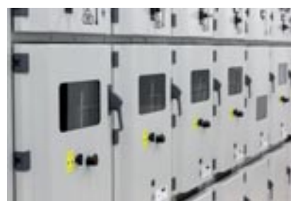
Prévention des risques de court-circuit et d'échauffement
